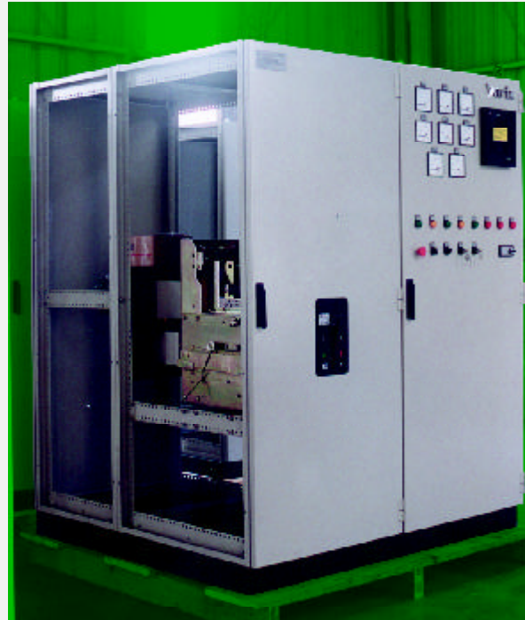
PAINEL DE DISJUNÇÃO, PROTEÇÃO E EXCITAÇÃO COM VEC 205
